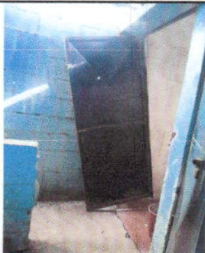
Foto 5: Puerta que será sustituida.
